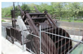
西番小水力発電所
