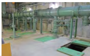
大浦汚水中継ポンプ場
